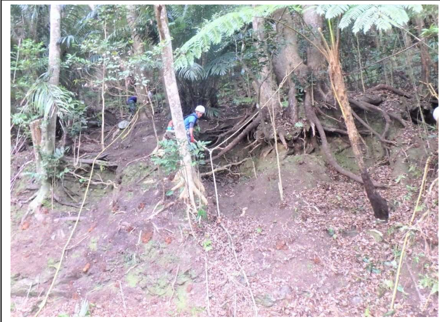
既存樹木根下 滑落による空洞化
