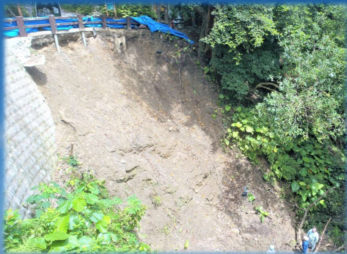
台風で崩壊した法面
